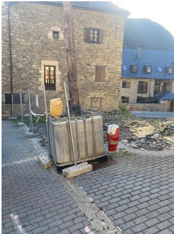
Fotografia 1. Dipòsit de formigó que obstaculitza l'ús de l'hidrant.
